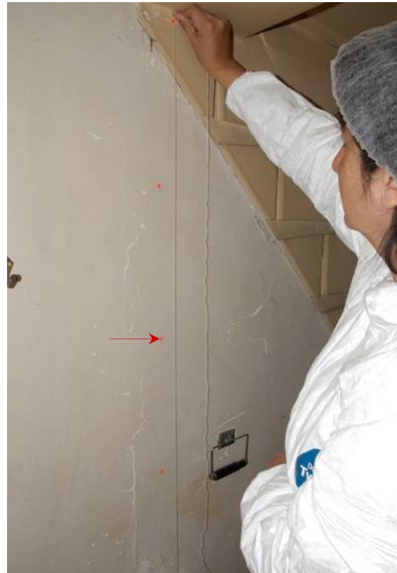
Figura 8: instalación de matriz cartesiana virtual en muro este. Los puntos rojos indican unidades de 30 x 30 cm.
