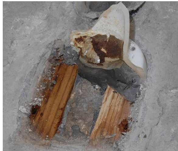
Figura 76: sistema de evacuación del baño 2, sellado con cemento tipo Pórtland, clavos y resina epóxica.
